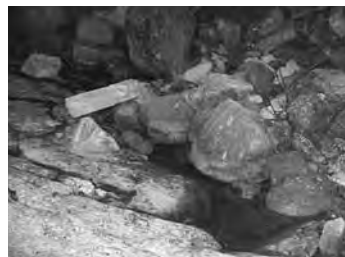
写真3 工事か所水たまり
