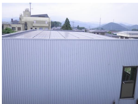
太陽光発電（南側倉庫）
