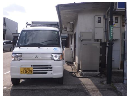
EV・PHV用充電設備
